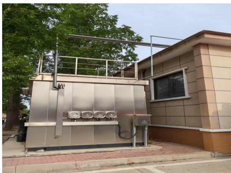
图 9 金陵石化厂内 VOCs 组分站
