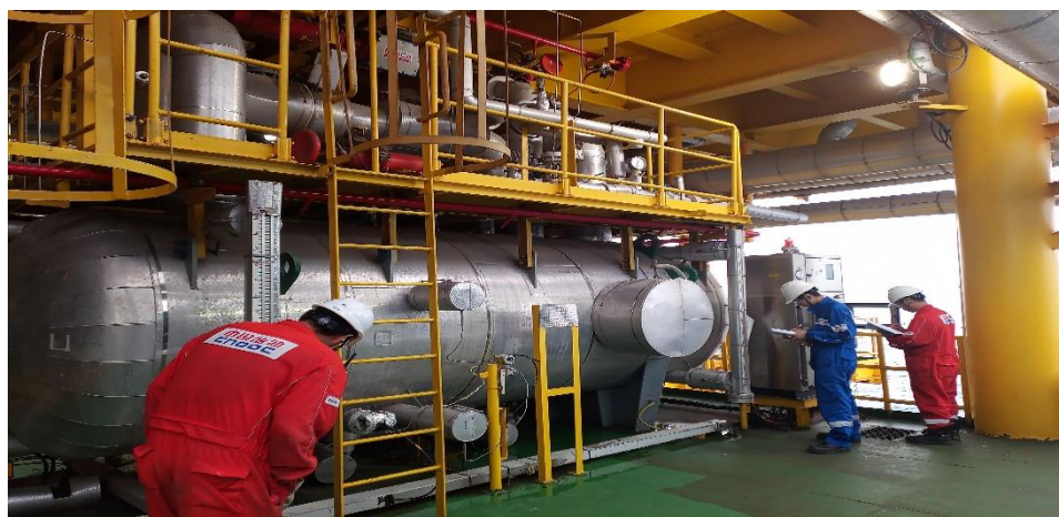
图2 曹妃甸11-6水封罐
