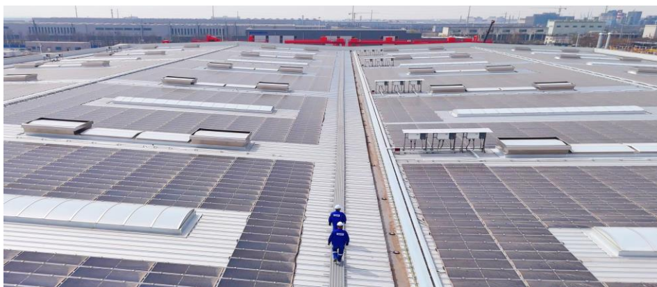
图 3 海油发展天津海洋装备智能制造基地屋顶 5.5 兆瓦分布式光伏项目
