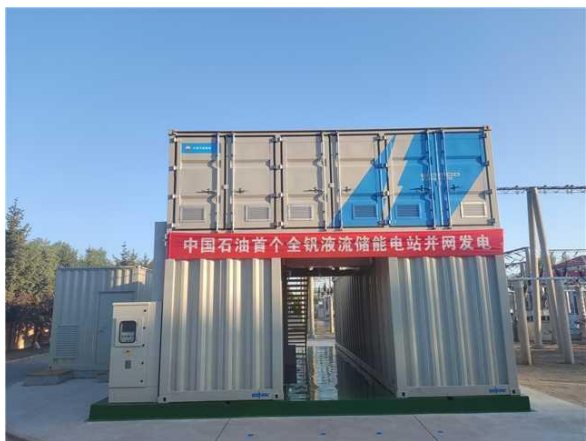
图 2 全钒液流储能示范项目
