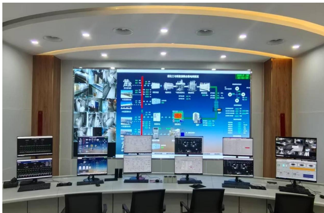
图 7 煤化工与新能源耦合项目监控画面
