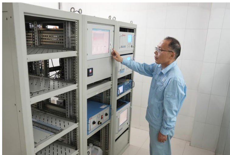
图 7 金陵石化自主建设厂界大气自动站
