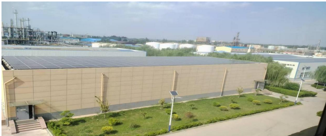
楼顶光伏发电系统
