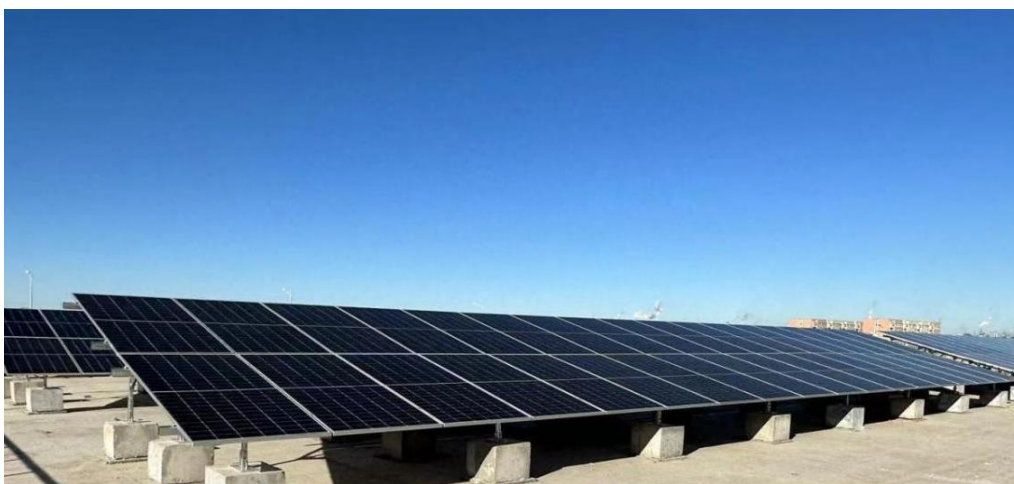
图 2：榆林化工利用厂房、屋顶设置光伏板发电
