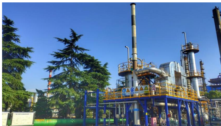
图 2 金陵石化厂南 VOCs 治理装置
