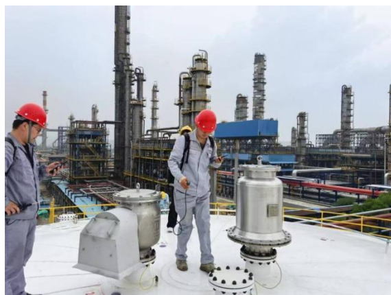
图4 储罐安装低泄漏呼吸阀
